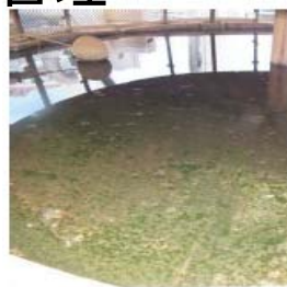
冷卻水塔之貯水池內藻類孳生情形
