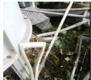
冷卻水塔周圍環境維護不佳情形
