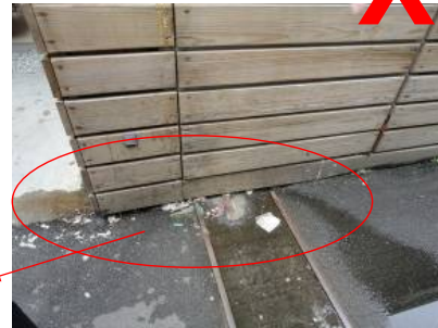
一般事業廢棄物貯存 區牆面破損，導致廢 棄物逸出、滲出
