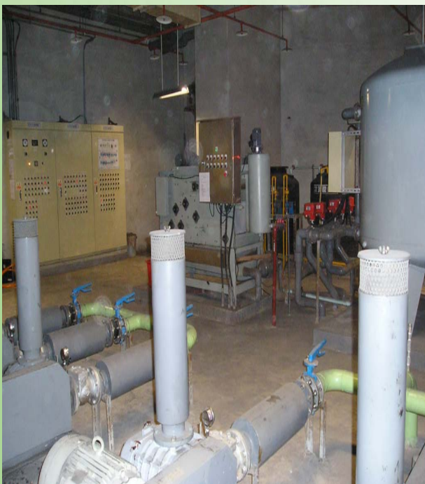
一般廢水處理機房
