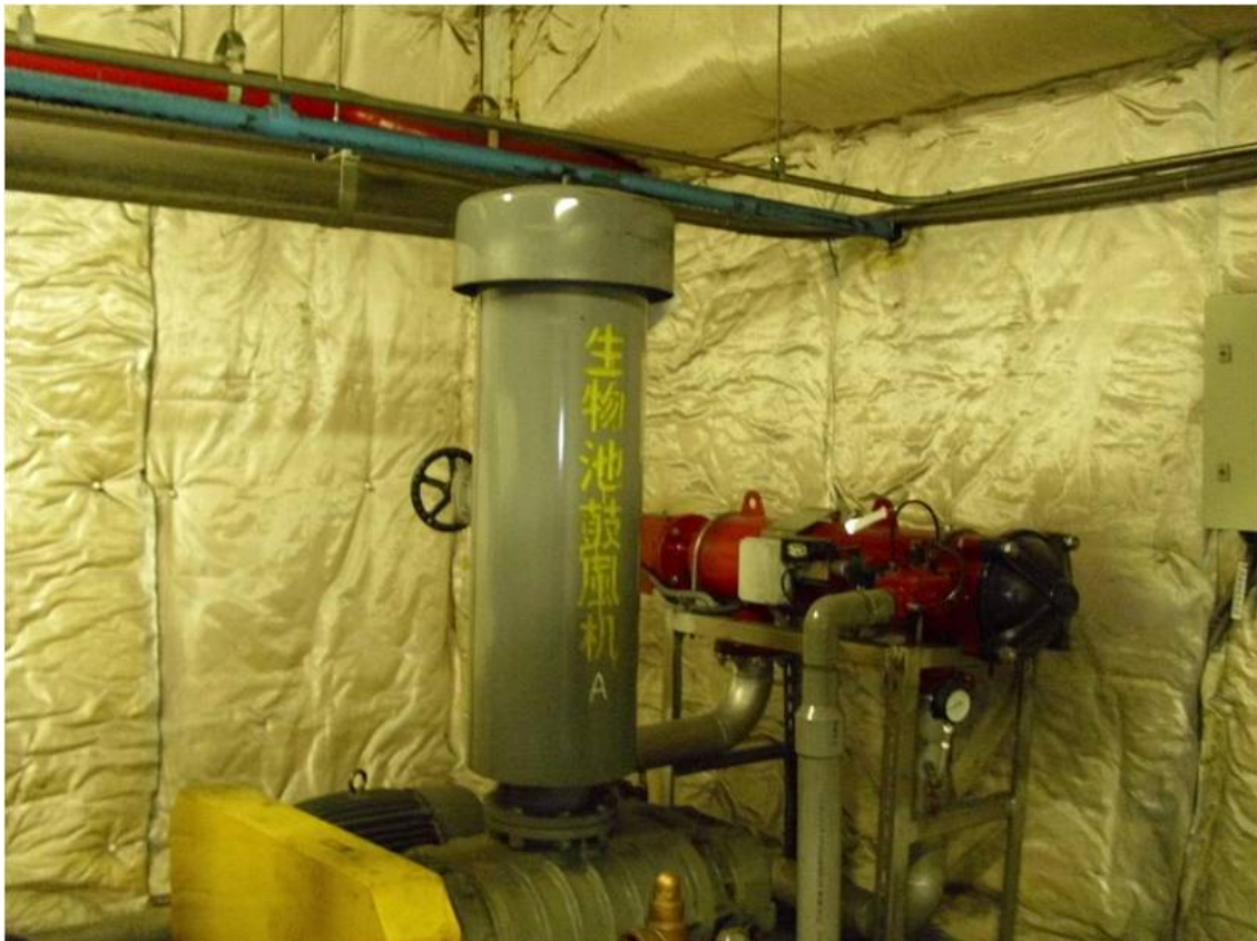
設備依規定標示
