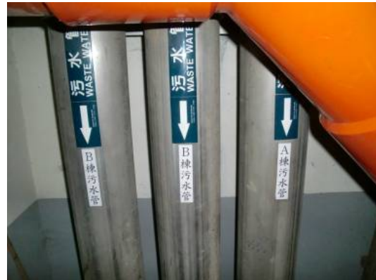
廢水分類收集處理
