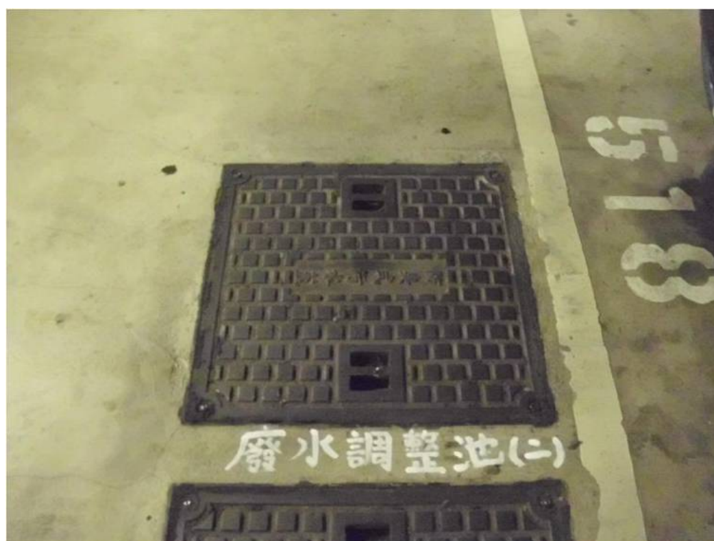
槽體依規定標示
