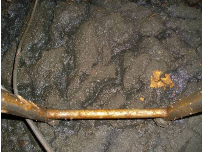
接觸曝氣池微生物死亡
